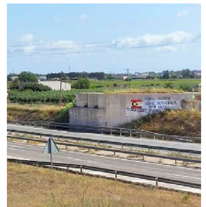
Aquest és el suport del pont sobre la N-340, que està en sentit Barcelona, enfront del desvio per entrar a Amposta.
