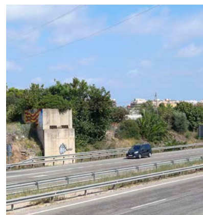
Aquests són els dos suports de formigó armat, un a cada costat de la N-340, on s'havia d'ancorar el pont del ferrocarril de Val de Zafán.
